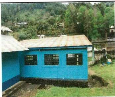
Foto 3: Imagen de ventanas que necesitan ser cambiadas.
