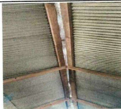
Foto 2: Imagen interior de de modulo 4 en donde se puede observar que se necesita cambiar la estructura de metal y asimismo el entechado.
