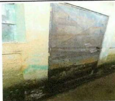
Foto 4: Fotografía de puerta en mal estado, que necesita cambio para brindar mayor seguridad al establecimiento.
